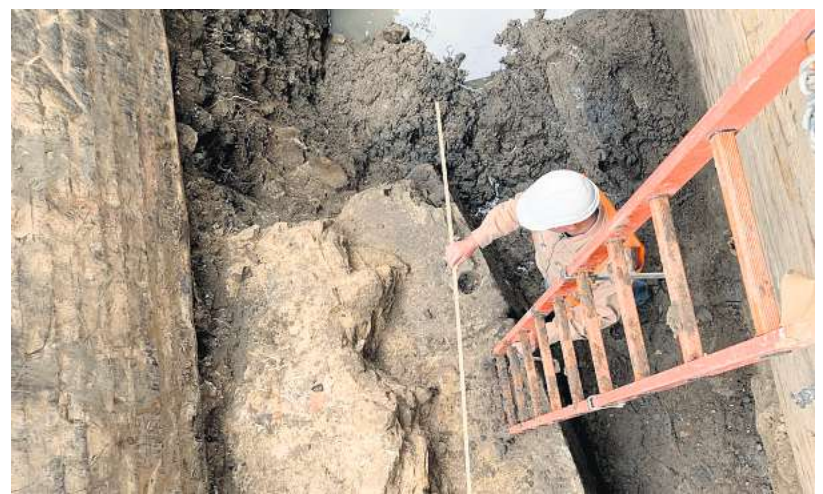
Die Entdeckung des Wehrturms auf dem Johannfriedhof führt zu keinen Verzögerungen im Bauablauf.
